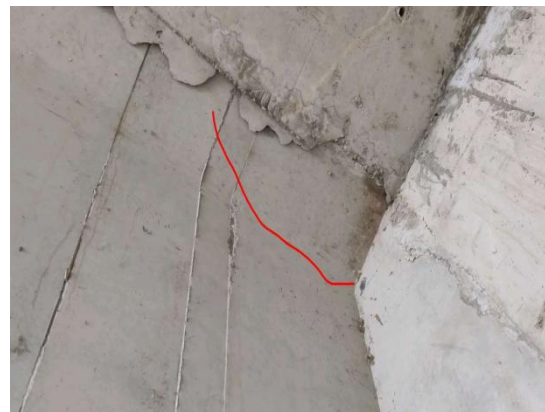
图 3-1：王坑特大桥右幅 R-1-2 箱梁：距 0 号台 0m 处，左侧，翼板与腹板交接处纵向裂缝；数量：1 条，长度：1.5m，宽度：0.12mm。
