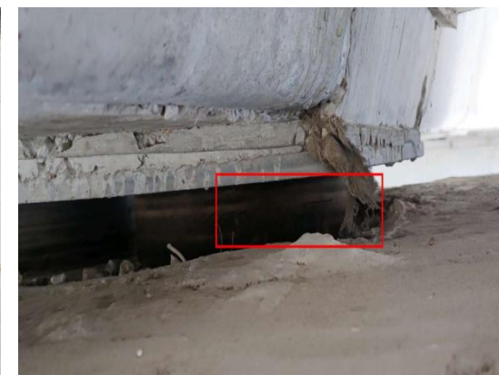
图 3-14：王坑特大桥左幅 ZZ-L-35-35-8 支座：左侧横向开裂；长度：0.3m，数量：1 条，宽度：1mm。
