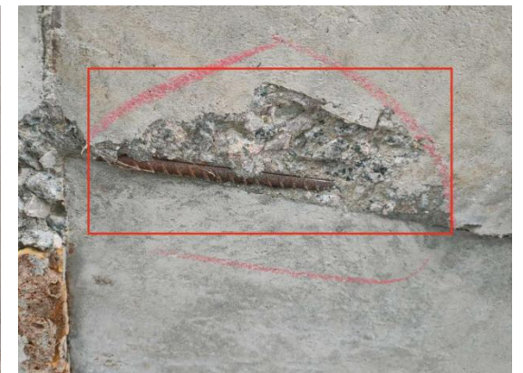
图 3-6：王坑特大桥左幅 L-23-3 箱梁：距 22 号墩 1m 处，梁底剥落；数量：1 处，长度：0.2m，宽度：0.1m
