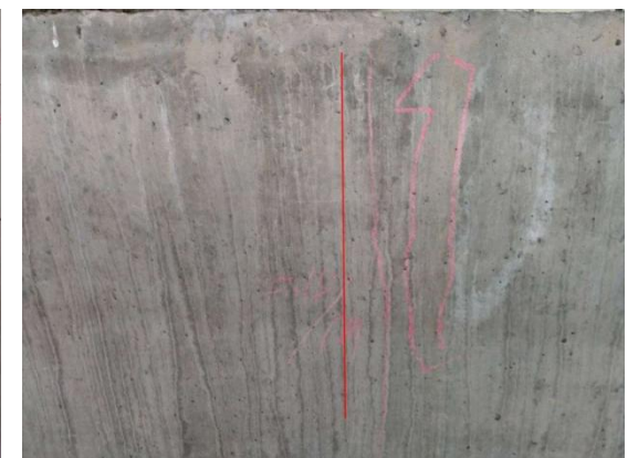
图 3-8：宁德滨海特大桥右幅 GL-1D 盖梁：距左侧 3m 处，大桩号面竖向裂缝；数量：1 条，长度：1m，宽度：0.15mm。
