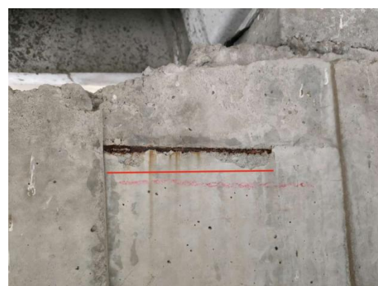
图 3-9：飞鸾互通主线桥右幅 GL-R-5D 盖梁：距左侧 7m 处，大桩号面露筋；数量：1 处，长度：0.15m。
