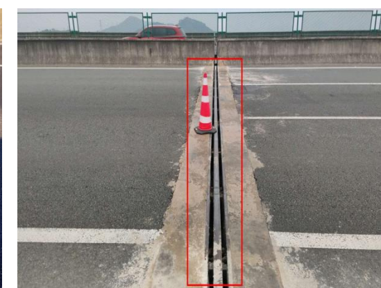
图 3-15：王坑特大桥上行 R-2f 伸缩缝：伸缩缝橡胶条橡胶带老化破损；数量：2 处，长度：14m，宽度：0.05m。
