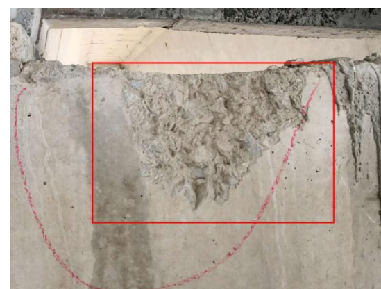
图 3-10：宁德滨海特大桥左幅 GL-75D 盖梁：距大桩号面 0m 处，距左侧 7m 处，大桩号面剥落；数量：1 处，长度：0.3m，宽度：0.3m。
