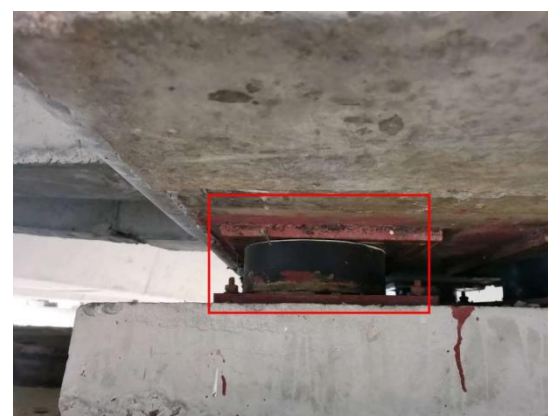
图 3-11：王坑特大桥右幅 ZZ-R-19-19-8 支座：小桩号面位置串动；数量：1 个，位移：0.05m。
