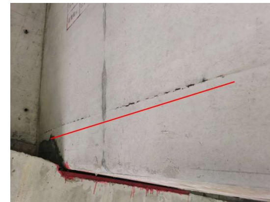
图 3-5：王坑特大桥右幅 R-2-4 箱梁：距 2 号墩 0m 处，左腹板露筋；数量：1 处，长度：1.5m。
