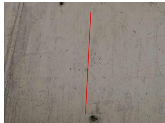
图 3-2：王坑特大桥右幅 R-6-3-4H 上部一般构件：小桩号面竖向裂缝；数量：1 条，长度：1.5m，宽度：0.18mm。
