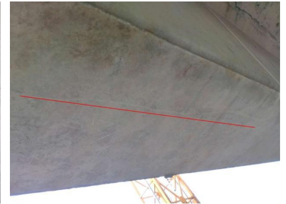
图 3-4：宁德滨海特大桥右幅 54-1 箱梁：距 54 号墩 5m 起，梁底纵向裂缝；数量：1 条，长度：3m，宽度：0.12mm。
