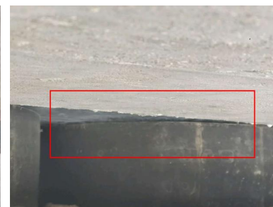
图 3-12：宁德滨海特大桥右幅 ZZ-217-6 支座：脱空；数量：1 个，百分比：50%。
