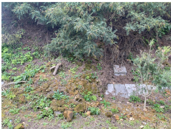
图 3 ZK5+450 左侧一级碎落台上方边坡溜方
