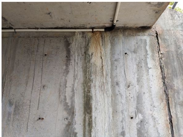
图 7 K3+680 涵洞右幅顶部与边墙搭接处流白
