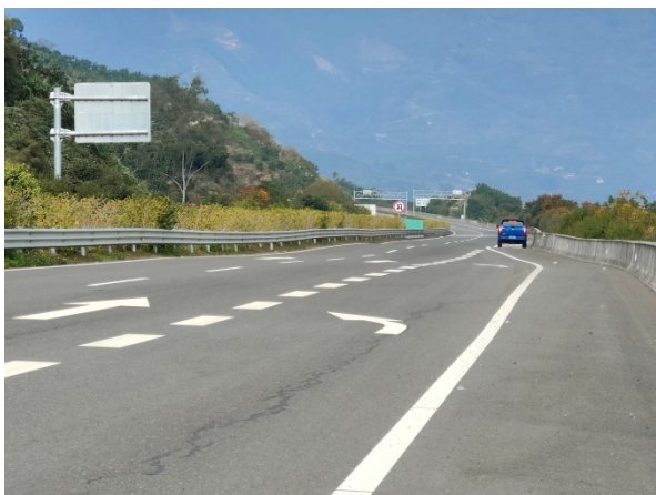
图 4 YK4+144-200 第 1、2 车道路基沉降 1 处
