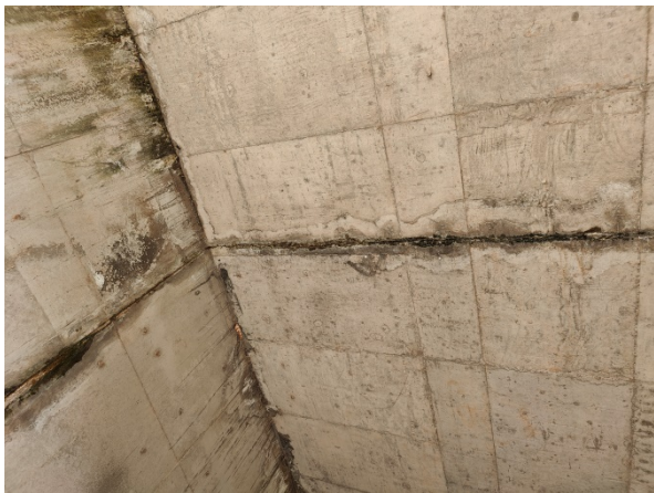
图 6 K3+960 涵洞右幅顶部渗水
