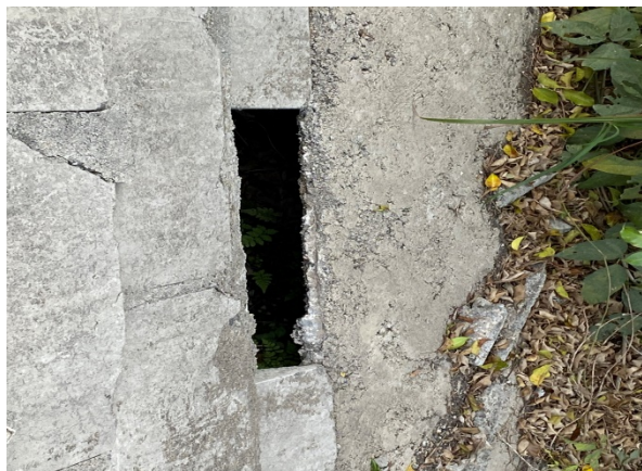
图 1 ZK4+280 左侧一级下边坡 1 处脱空，S=4×1 m²
